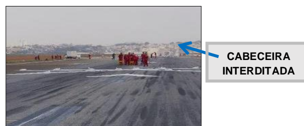
Figura 2: Cabeceira interditada em uma das Pistas do Aeroporto Internacional de Guarulhos.
