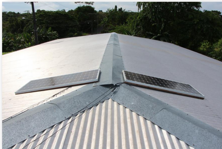
Figura 4 Posição dos painéis fotovoltaicos na superfície do telhado da residência estudantil do Instituto Federal do Amazonas – IFAM, Campus São Gabriel da Cachoeira – AM.
