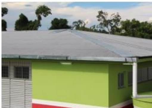
Painel fotovoltaico Residência do IFAM
