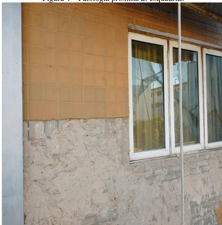
Figura 4 – Patologia próxima às esquadrias
