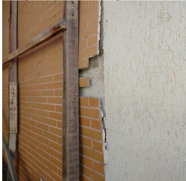
Figura 8 – Deslocamento das placas cerâmicas
