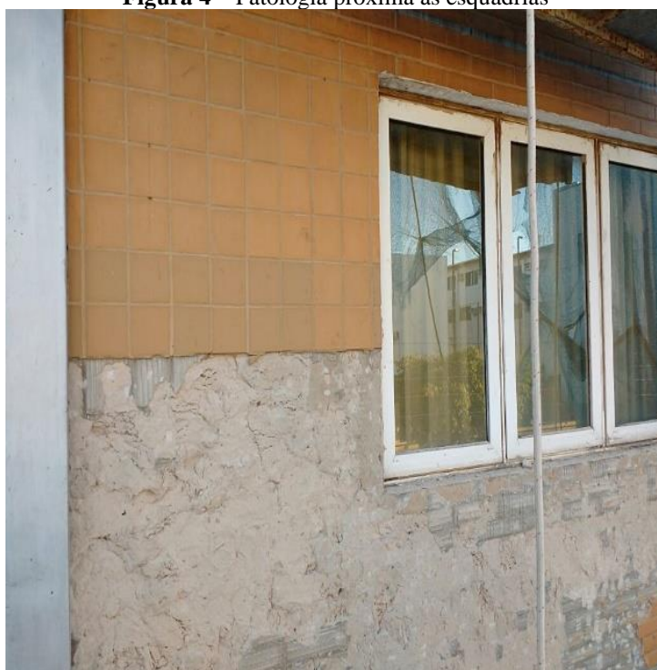
Figura 4 – Patologia próxima às esquadrias
