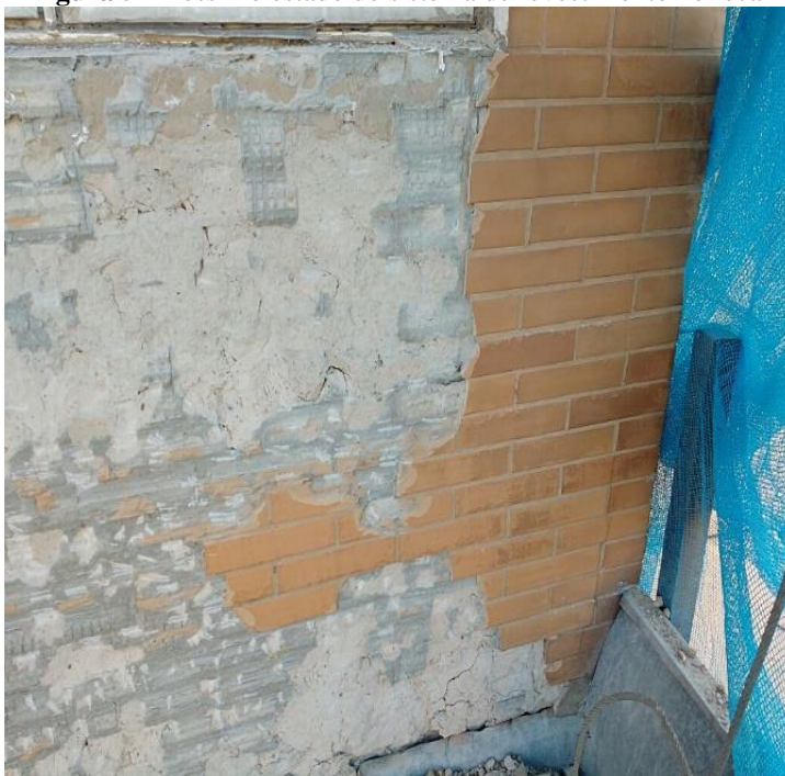
Figura 5 – Péssimo estado do sistema de revestimento no local
