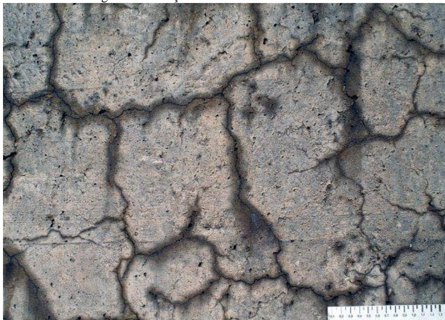
Fig. 1 – Fissuração observada no bloco de concreto
