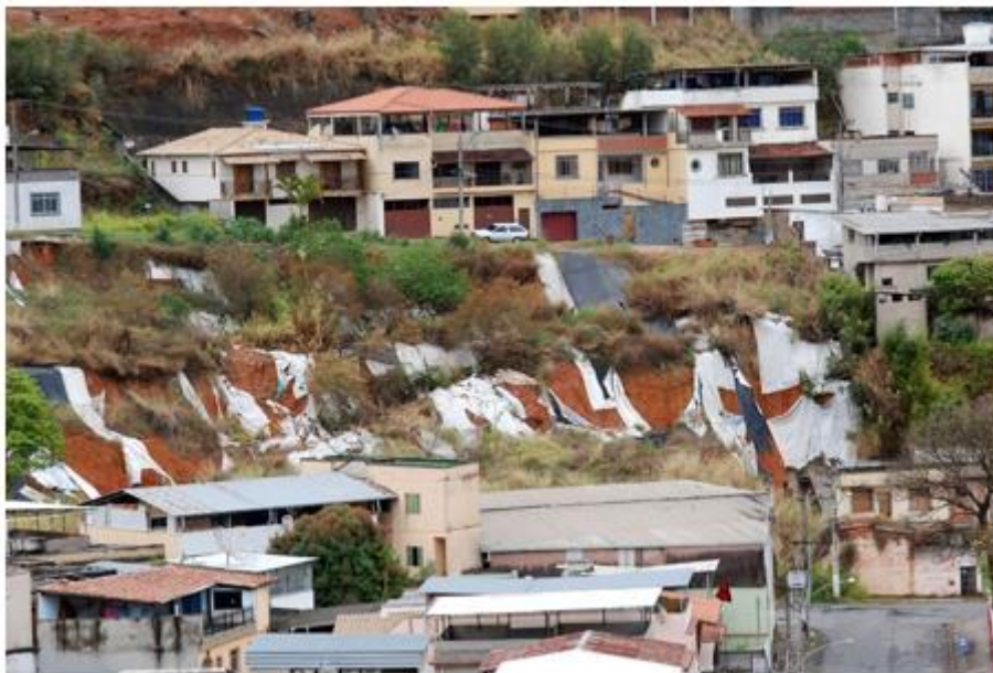
Figura 5: Bairro Santa Tereza, escorregamento, setor urbano Sudeste. Fonte: Tribuna de Minas (2008).
