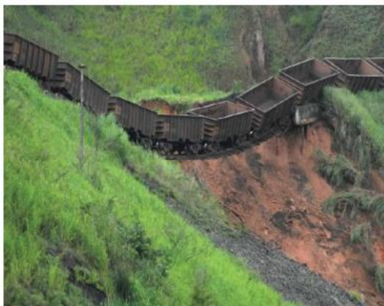
Figura 7: Descarrilamento de vagões devido a movimento de massa visível na foto pela ausência de vegetação abaixo da linha férrea. Fonte: Tribuna de Minas (2011).
