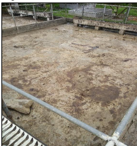
Figura 6 - Presença de irregularidades no solo e cantos vivos nos currais do abatedouro 2.
