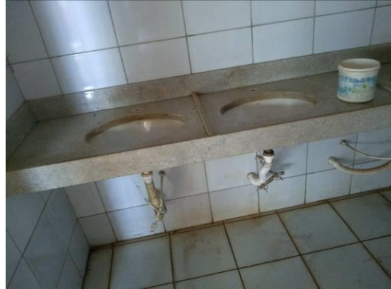
Figura 1 – Banheiro inapto ao uso
