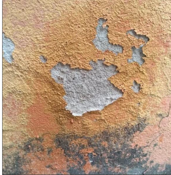
Figura 6: Carbonatação no concreto exposto.
