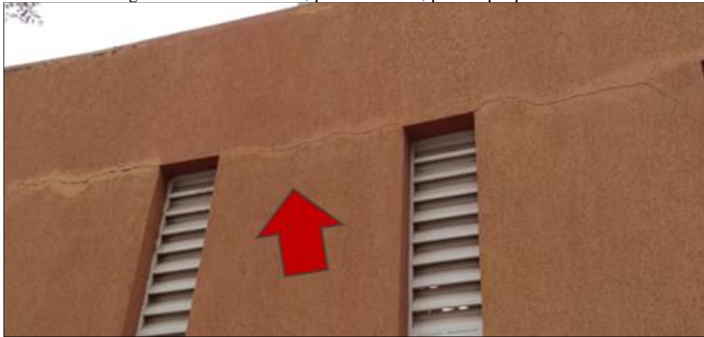
Figura 7: Fissura causada, possivelmente, por ataque por sulfato.
