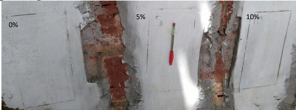
Figura 2 - Imagem do dia 06/05/2020 do reboco realizado em 08/12/2018 com 0%, 5% e 10% de RIG.
