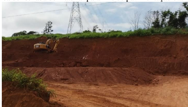
Figura 7. Área de retirada de material para fins de pavimentação das vias públicas.
