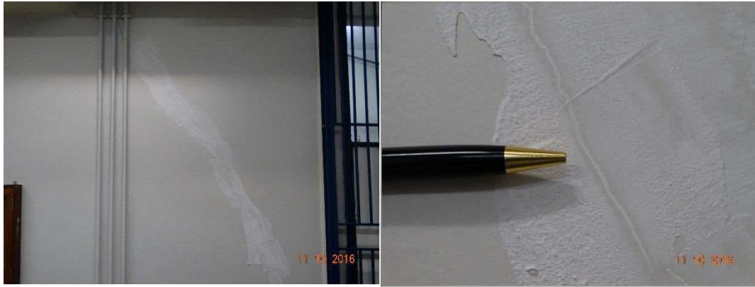
Figura 19 –Monitoramento da rachadura na alvenaria interna no canto esquerdo da sala do cofre , aparentemente não ativa. (Fonte: autores)
