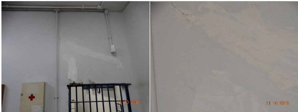
Figura 17 – Monitoramento da rachadura na alvenaria externa acima da porta de acesso do cofre, aparentemente não ativa. (Fonte: autores)
