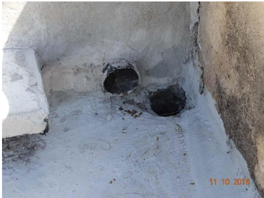
Figura 10 –Ductos de água sem ralo abacaxi. (Fonte: autores)
