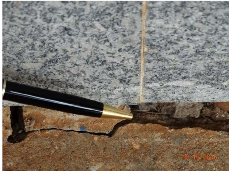
Figura 23 –Abertura entre piso e parede. (Fonte: autores)
