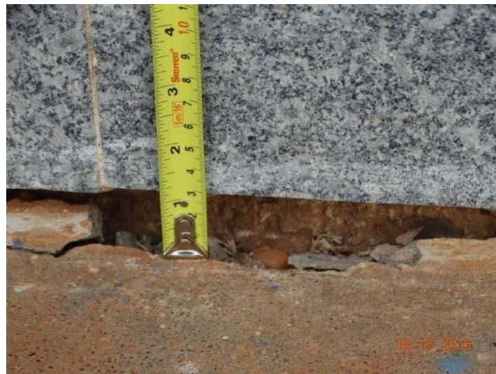
Figura 24 –Abertura de 3 (três) cm entre piso e parede. (Fonte: autores)
