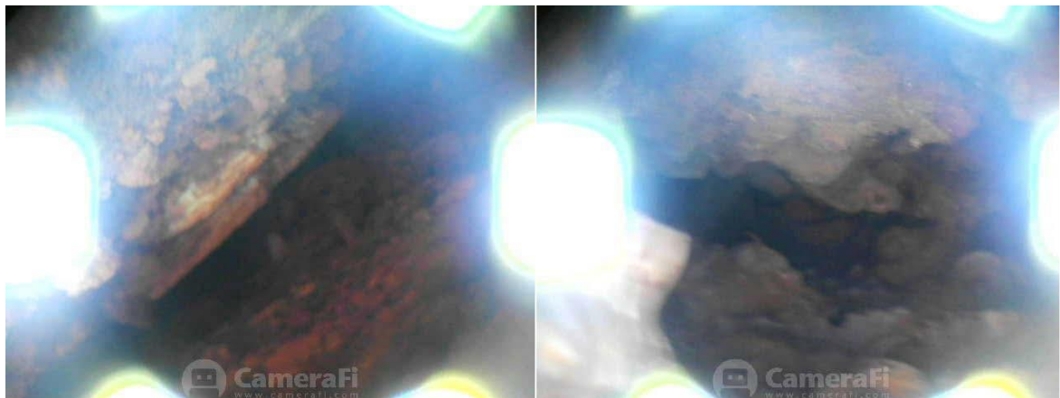
Figura 26 –Parte interna abaixo da calçada com espaços vazios devido a movimentação do solo. (Fonte: autores)
