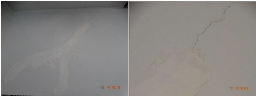
Figura 18 – Monitoramento da trinca na alvenaria interna acima da porta de acesso do cofre, aparentemente não ativa. (Fonte: autores)
