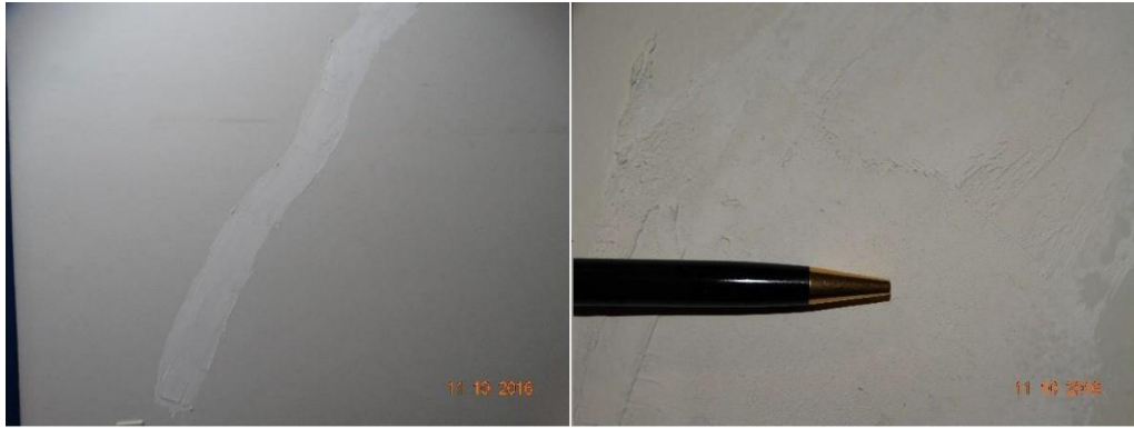
Figura 16 – Monitoramento da trinca na parede externa do cofre, aparentemente não ativa. (Fonte: autores)
