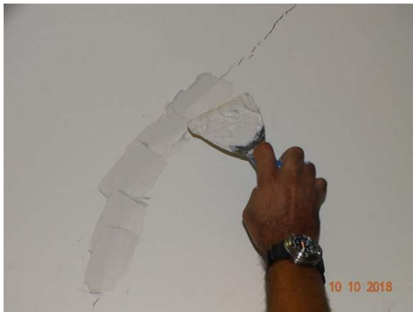
Figura 14 –Trinca em alvenaria da edificação. (Fonte: autores)
