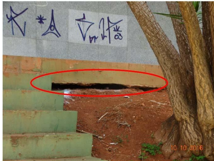
Figura 22 –Falha na parte interior da calçada externa na fachada norte. (Fonte: autores)
