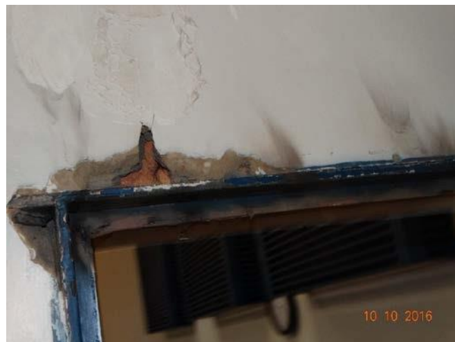
Figura 13 – Porta de entrada ao cofre sem verga. (Fonte: autores)
