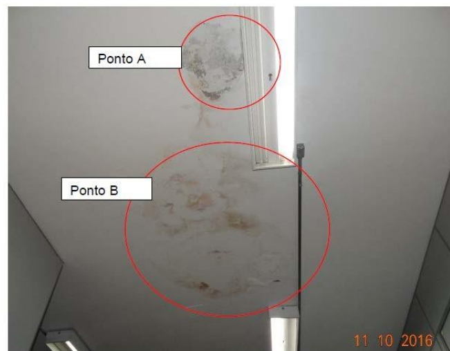
Figura 07 –Ponto de infiltração na laje de cobertura docorredor do Detran. (Fonte: autores)
