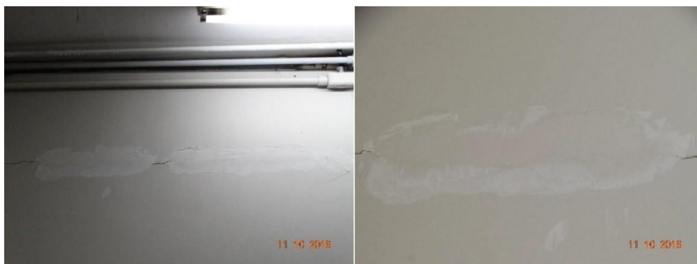
Figura 15 – Monitoramento da rachadura na parede externa do cofre, aparentemente não ativa. (Fonte: autores)
