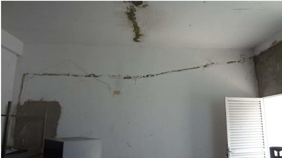
Figura 10 –Rachadura na junção da viga com parede de alvenaria e com o pilar. (Fonte: autores)
