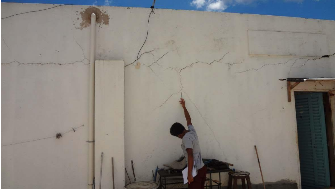
Figura 06 –Fissuras na fachada lateral esquerda da edificação. (Fonte: autores)
