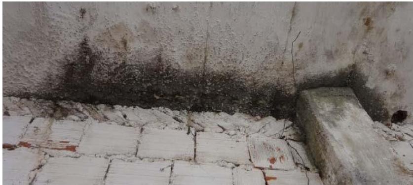
Figura 07 –Mancha de infiltração na laje e no pilar. (Fonte: autores)
