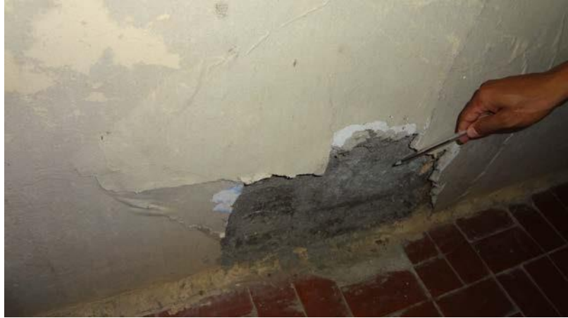
Figura 09 –Deslocamento de revestimento argamassado. (Fonte autores)
