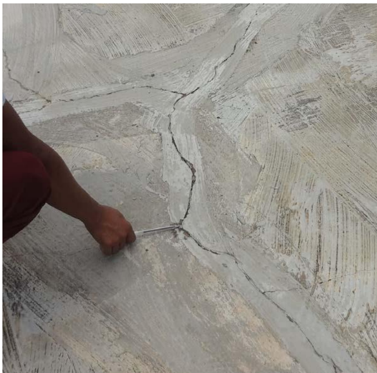
Figura 03 –Trincas na laje de piso. (Fonte: autores)
