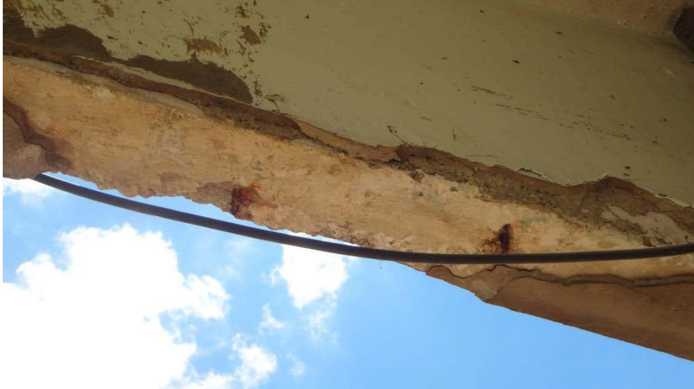
Figura 04 –Armadura exposta e corroída na platibanda. (Fonte: autores)
