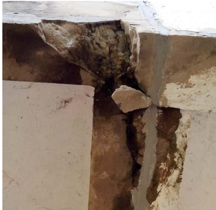
Figura 05 –Junta de dilatação deteriorada na platibanda. (Fonte: autores)
