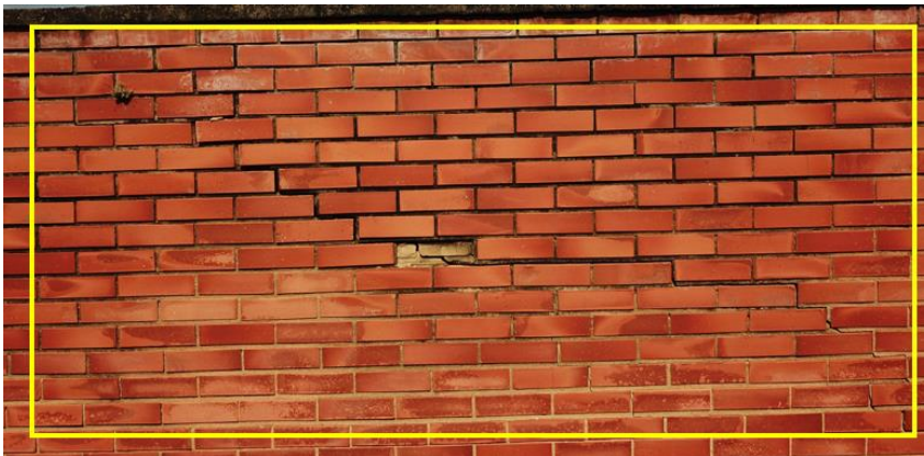
Figura 10 –Inspeção visual da parede lateral no alto da edificação. Descolamento do revestimento.
