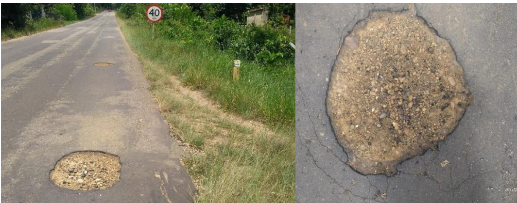
Figura 4. Panelas encontradas na SE-065
