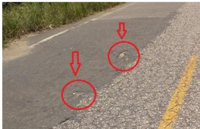
Figura 3. Início de deterioração em remendo da SE-065
