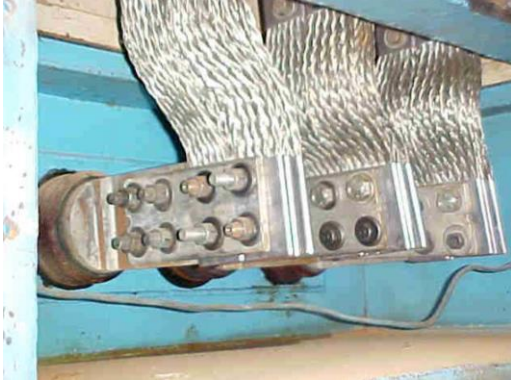
Figura 3 – Terminais de saída de um transformador
