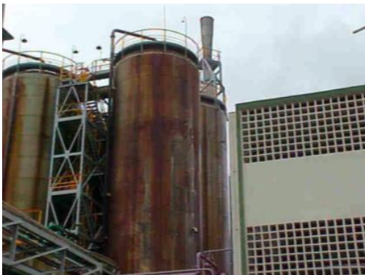
Figura 5 – Superfície de uma torre de condensação
