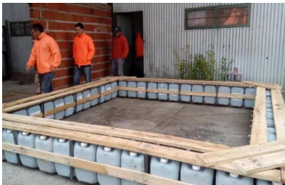
Fig. 1. Trabajadores del "Club Laguna Vitel" durante uno de los talleres de construcción de jaulas flotantes.
