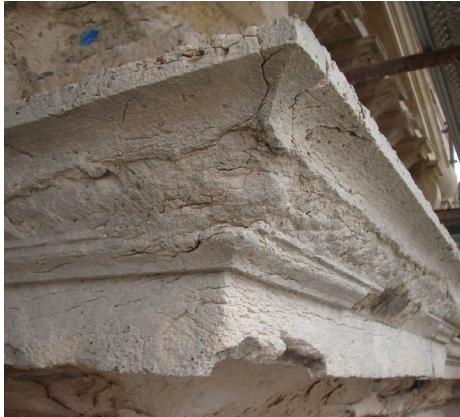
Desconchados (PF7) Spalling (PF7)
