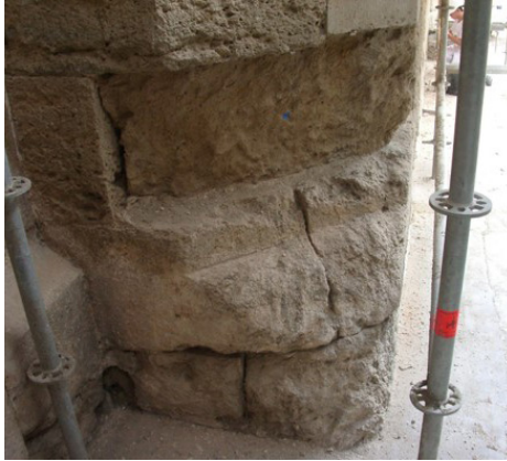
Disgregación (PF10) Disgregation (PF10)
