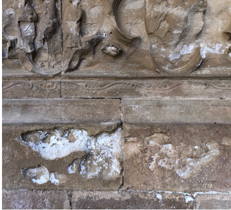
Eflorescencia (PE1) Efflorescence (PE1)
