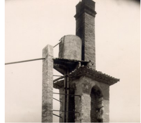
Elementos impropios (PA3) Improper elements (PA3)
