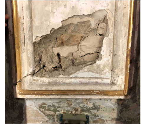
Pérdida de superficie (lagunas) (RF6) Loss of surface material (gaps) (RF6)
