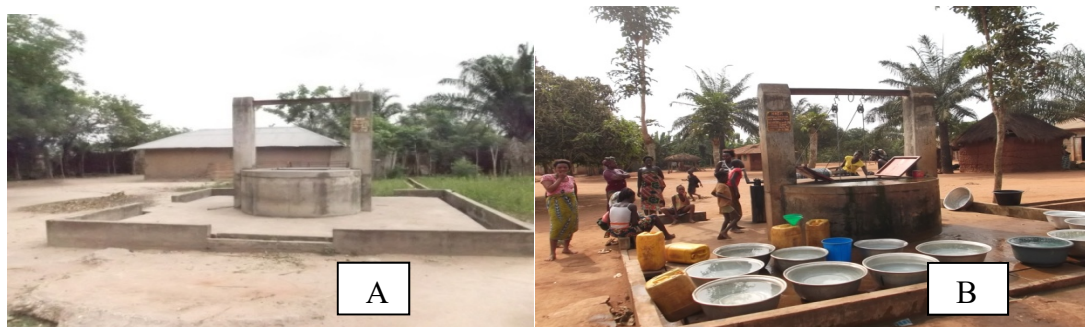
Planche 2: PM muni d'un système de treuil dans les Arrondissements de Lon Agonmey et Sékou
