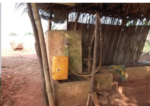
Photo 7 : Borne Fontaine de Tankpa reliée à l'AEV de Bawékanmè à Ahouannonzoun
