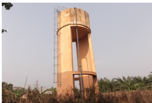
Photo 6 : Château d'eau de l'AEV de la localité de Bawékanmè à Ahouannonzoun
