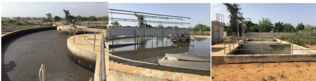
Fig.3: Bassin à boues activées, un bassin de décantation secondaire, traitement tertiaire (de gauche à droite)
