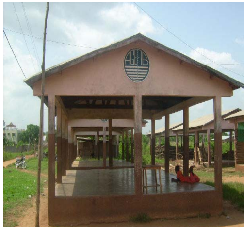
Photo 2 : Etat délaissé du marché de Houin.
