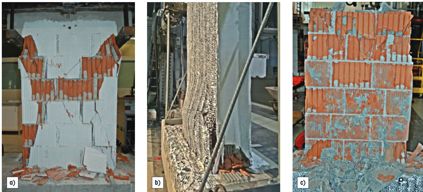
Slika 13 • a) Zid W4 po koncu preiskave; b) razslojevanje in uklon obloge zidu W12; c) poškodbe zidu pod oblogo (po odstranitvi obloge).
