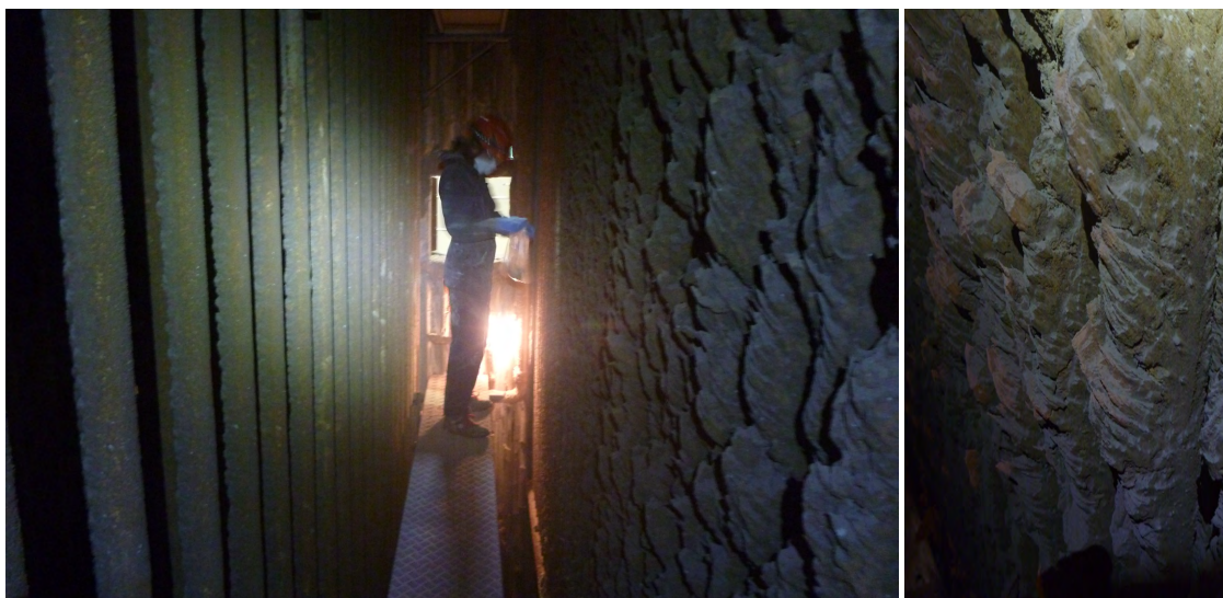
Figure 7.2: Probenahme im Kessel zwischen Überhitzer 1 und 2, Rauchgasrichtung nach links. Die Wächten haben sich gegen die Rauchgasrichtung ausgebildet.
