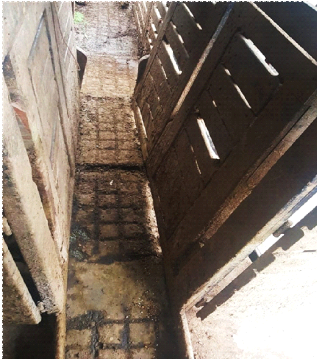
Figura 8. Casilla de operación. Fuente: elaboración propia
