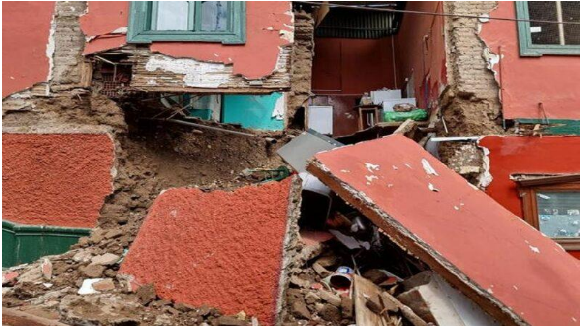
Figura 4. Casona de Barranco después del colapso.
