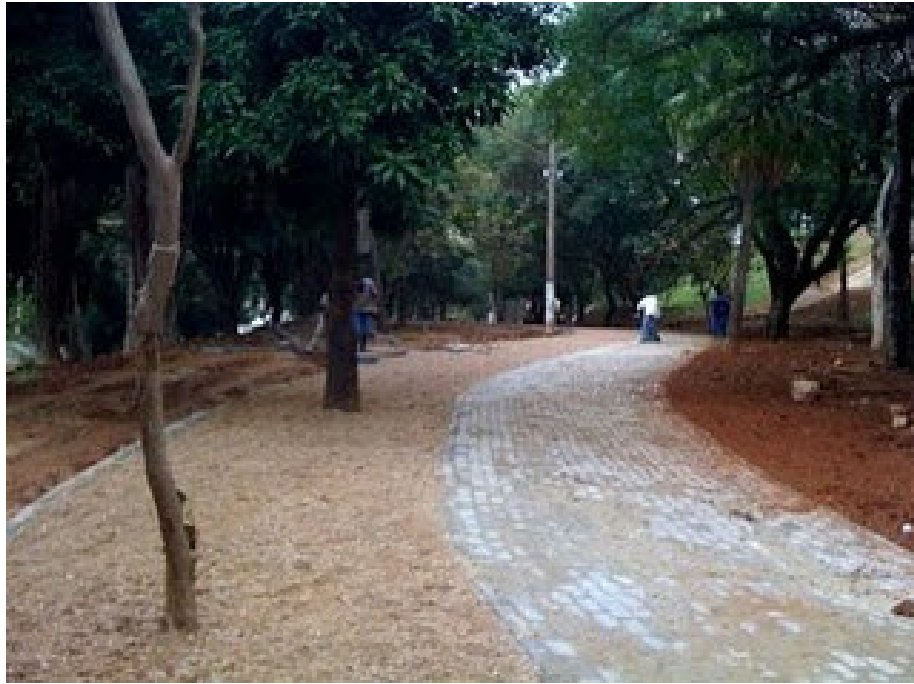
FIGURA 3.23 – Pisos permeáveis ou semi-permeáveis utilizados. FONTE: PMSP, 2010.
