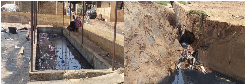
Photo 4. Etat d'une fosse de traitement. Photo 5. Point de rejet des eaux usées du centre dans la rivière.
