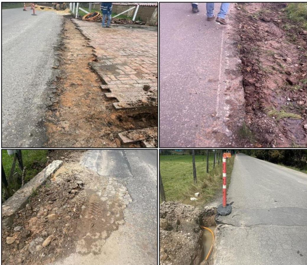
Figura 11. Afectaciones al estado previo de la Vía.
