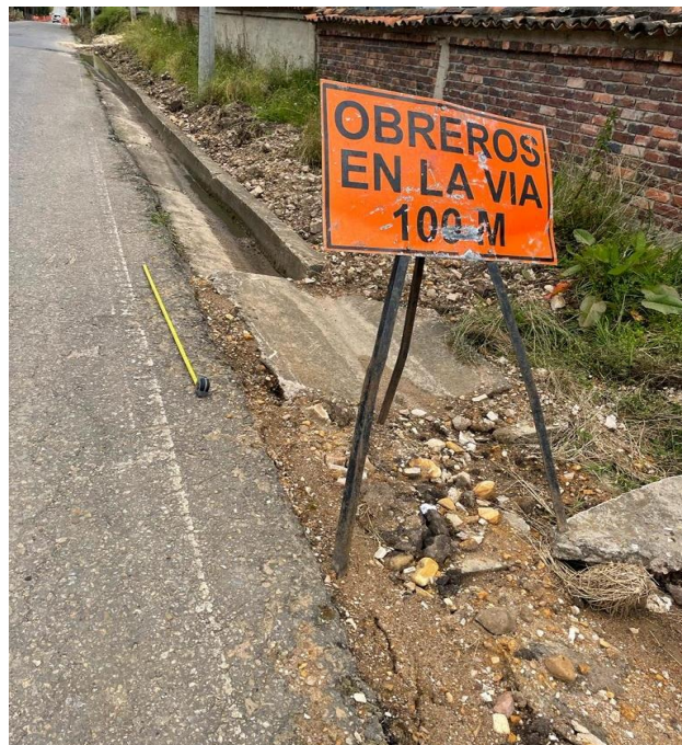
Figura 12. Daño directo a cuneta y señal en mal estado
