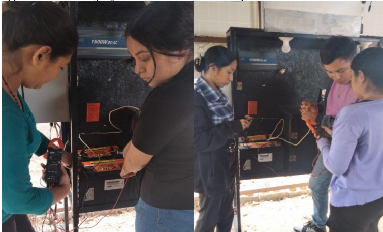
Figura 7. Montaje y conexión en serie o paralelo de las baterías fotovoltaicos
