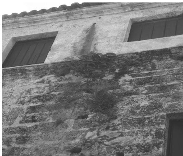
Fig. 1. Crecimiento de biota, presencia de costra por contaminación y pátina debido a desagües en la pared de la calle de los Oficios del Convento y Basílica Menor de San Francisco de Asís.
