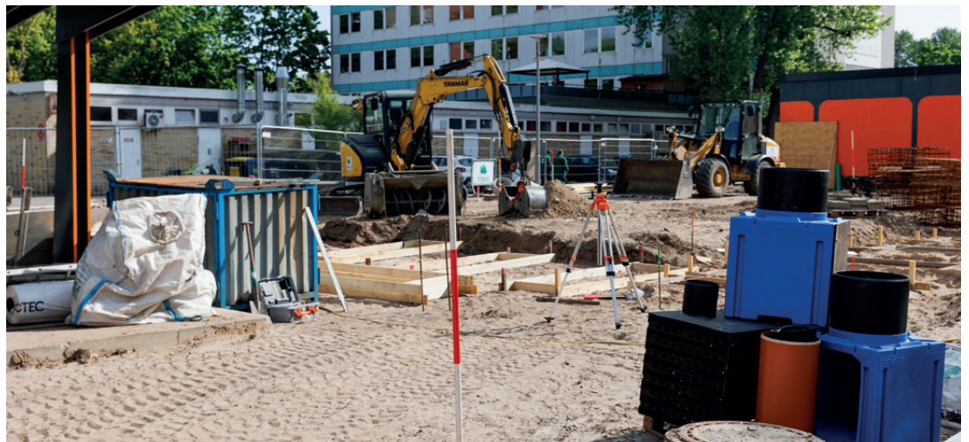
Am 3. Bauabschnitt des Grünzuges gehen die Arbeiten voran. Zwischen den beiden Ausgängen des U-Bhf. Halemweg werden derzeit die Fundamente für den Ballfang-Zaun gesetzt und die Rigolen (rechts im Bild) für das Regenwasser in den Boden versenkt.
