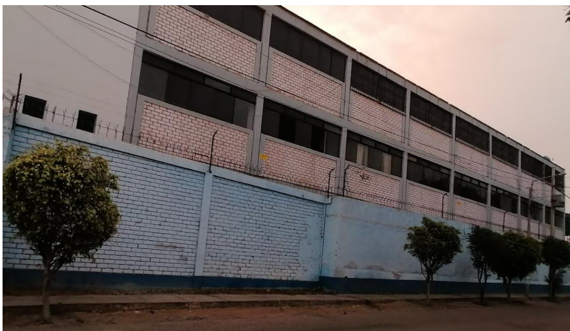
FIGURA N° 23: Construcción no planificada, generando una múltiple fachada
