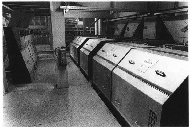
Bild 3. Produktionsanlage mit BWG-Farbglassortiergeräten einschließlich der dazugehörigen Schaltschränke.
