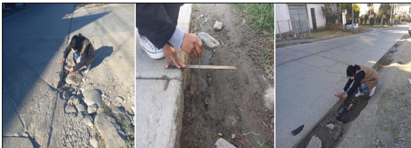
Socavación de la vía prolongación Cusco
