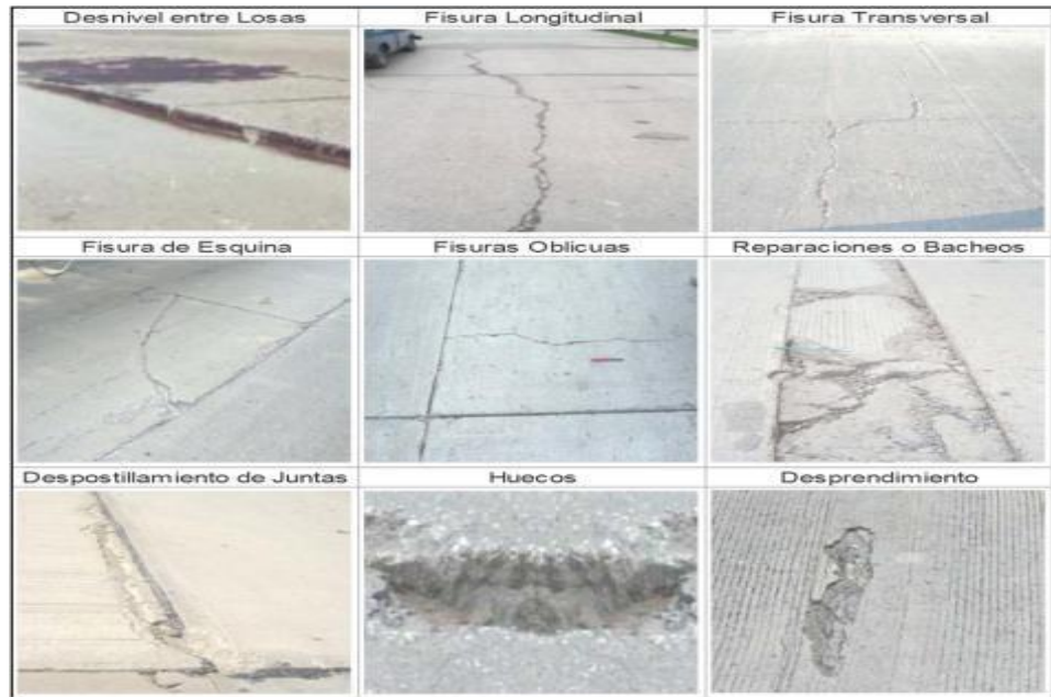
Figura 28. Daños en pavimentos rígidos.
