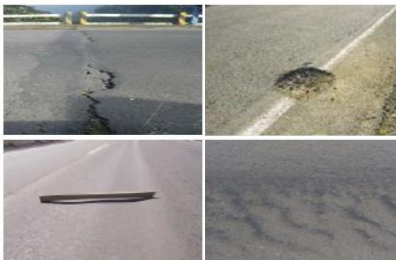
Figura 15. Fisuras, baches, ahuellamiento y exudaciones.
