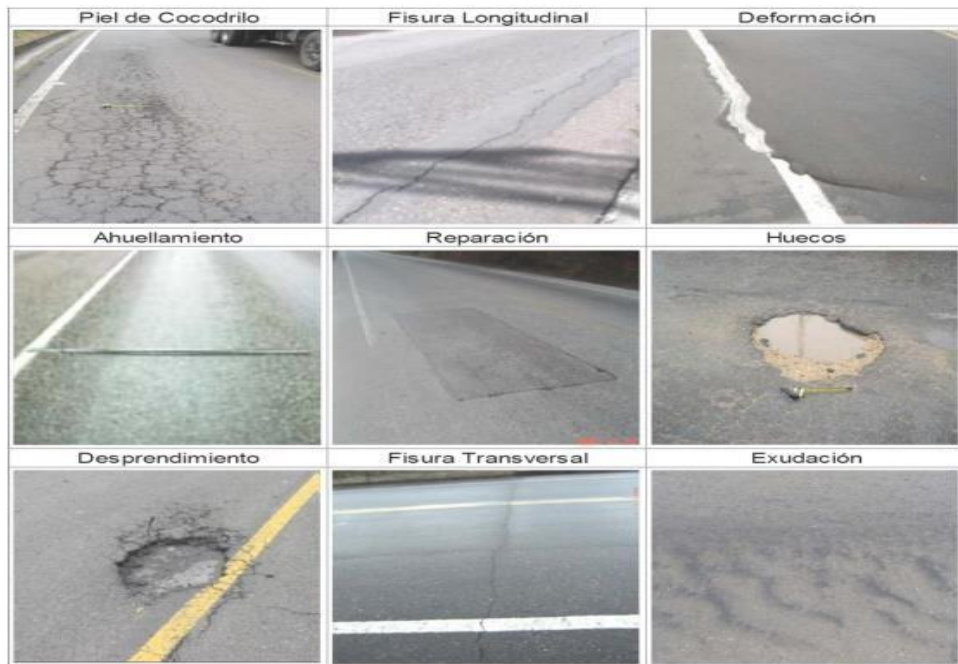
Figura 26. Daños en los pavimentos flexibles.
