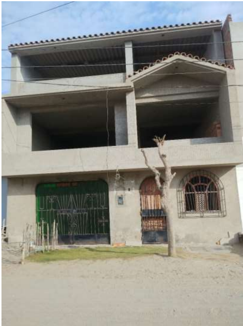
Figura N° 10: Vivienda de 02 pisos+ azotea. Observamos las tabiquerías deterioradas en primer piso. Los muros estructurales tienen eflorescencia, que afecta al aspecto de la superficie y con el tiempo se desborona.
