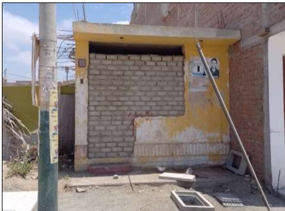
Figura N° 08: Módulo de Enase, Vivienda abandonada. Se observa los aceros de las estructuras principales expuestas al medio ambiente, sin recubrimiento alguno.
