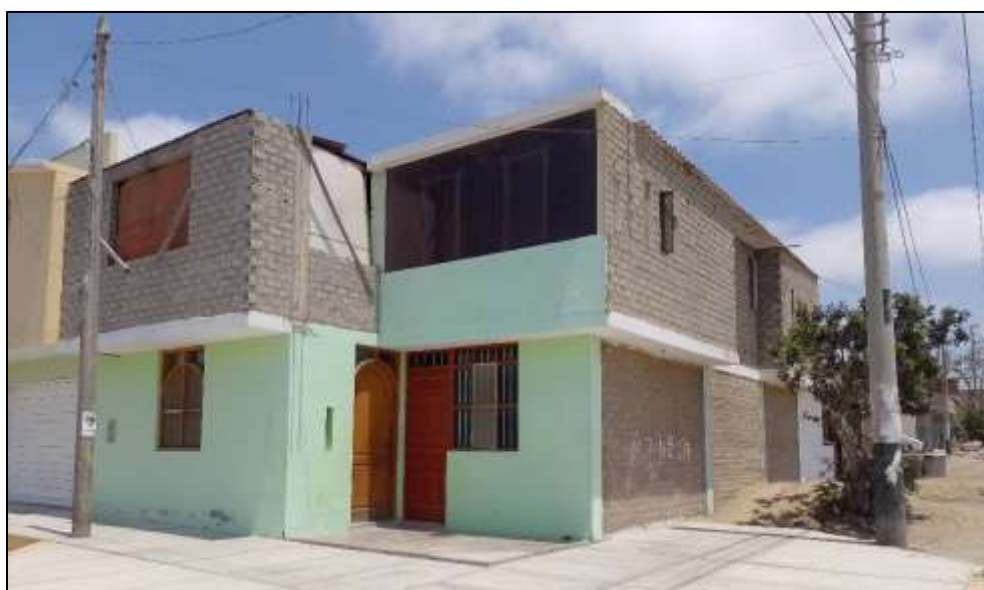
Figura N° 09: Vivienda de 02 pisos. Observamos el uso del ladrillo de concreto, que es un material deficiente para la resistencia de la densidad de muros, el acero de refuerzo de las columnas expuestas al medio ambiente, no cuenta con vigas peraltadas. cubierta flexible Eternit.
