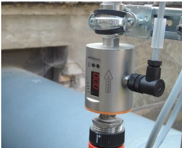
Abbildung 2.3-2: Durchflussmesser am Dachzulauf.
