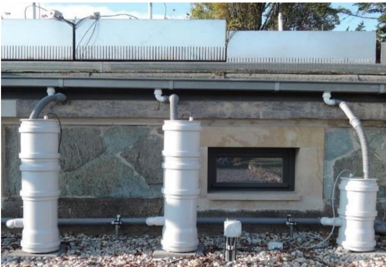
Abbildung 2.3-3: Sammelbehälter mit Messung von geschlitztem Auslass.
