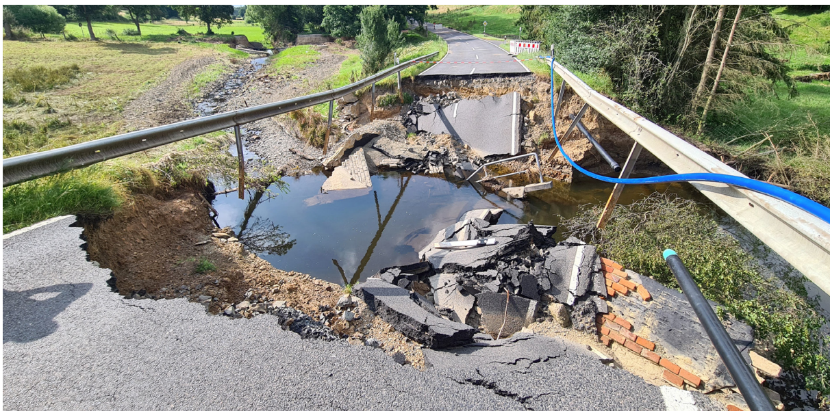
Bild 13 Schäden am Bauwerk L113/8 über den Houverather Bach
