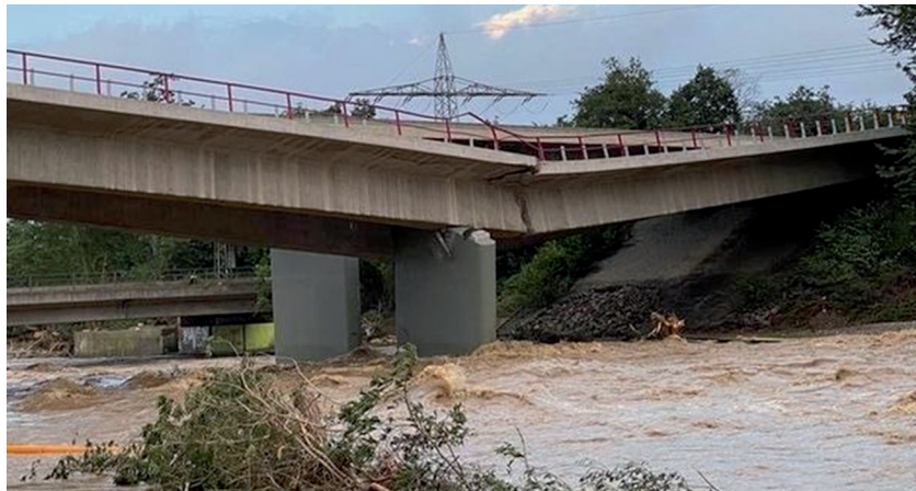
Bild 9 Beschädigtes Brückenbauwerk BW 5409 506 2
