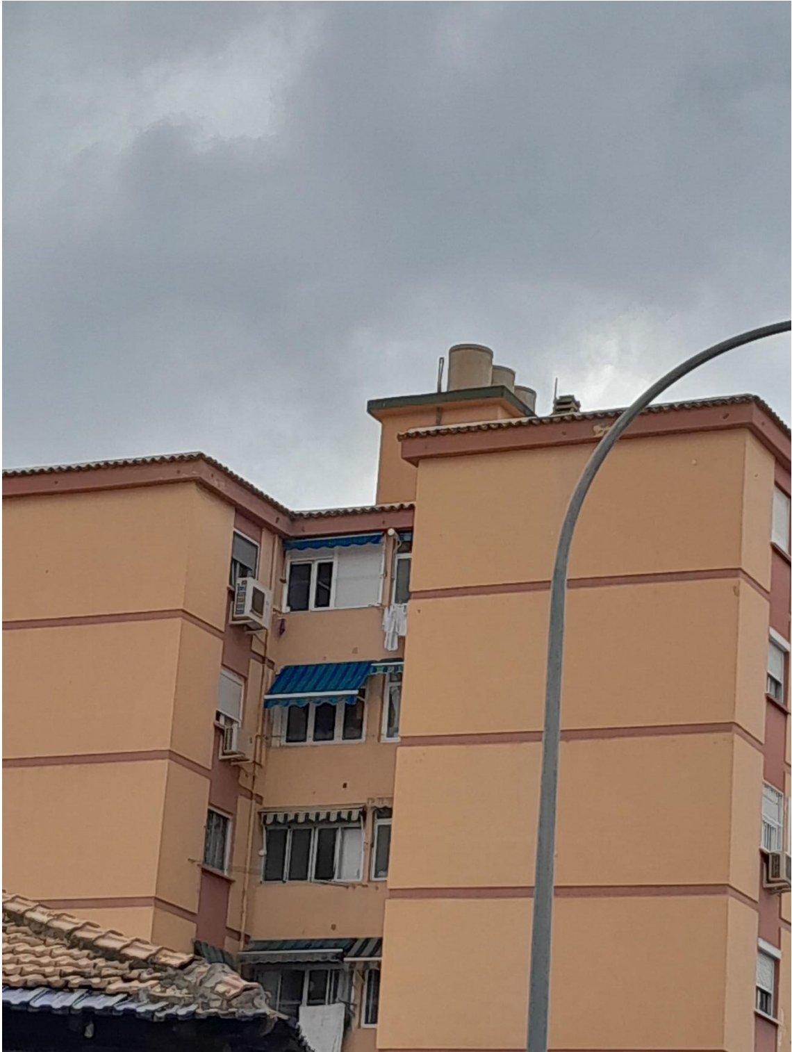
Figura 2. Depósitos de agua y tuberías de fibrocemento sobre edificios en Málaga (Spain)
