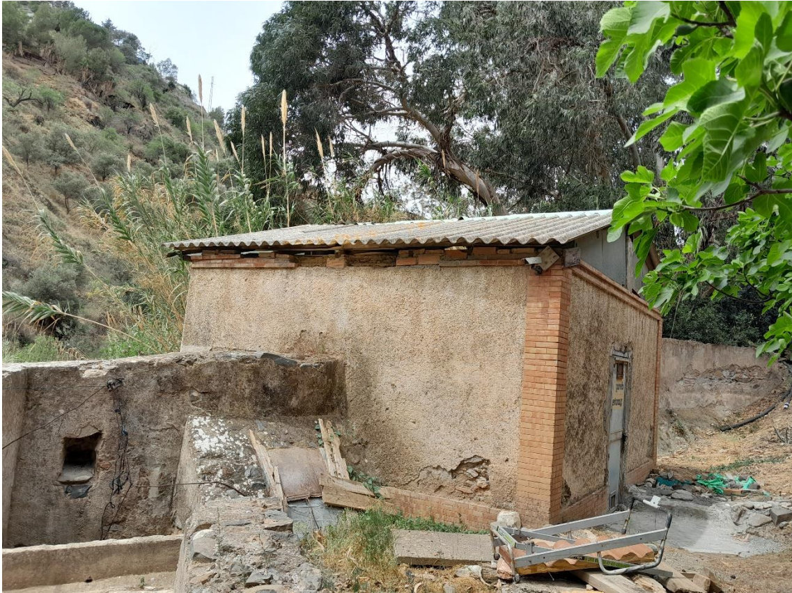
Figura 1. Cubiertas de fibrocemento sobre depósito de agua Canal Acueducto de San Telmo. Málaga (Spain).
