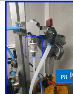
P8 - Despressurização da pressão do Óleo
