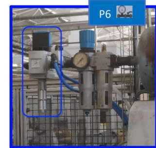
P3 - Ar comprimido. Baixada L99 – Prensa (Bypass)
