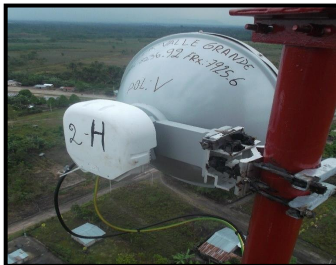
Figura 5.4- Antena 0.6m, ODU Instalada en Torre (Apuntando a V.GRANDE) Fuente: Elaboración Propia
