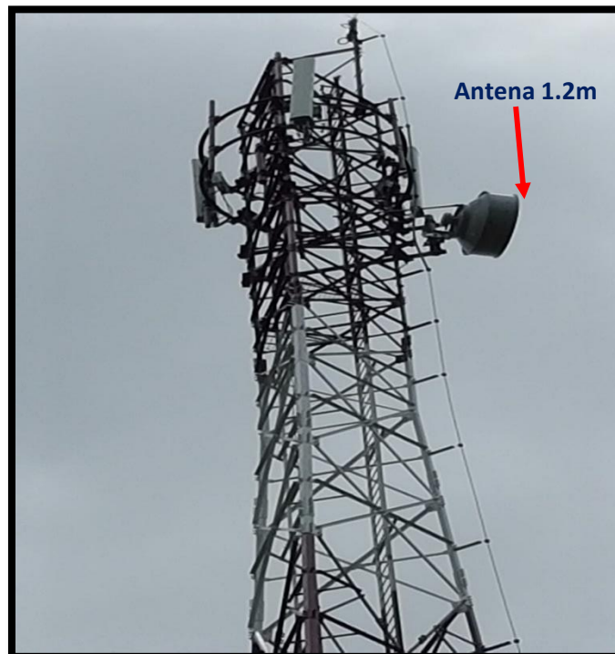
Figura 5.8- Torre y Antena Instalada Fuente: Elaboración Propia
