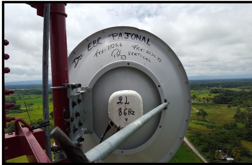
Figura 5.9- Antena 1.2m, ODU Instalada en Torre (Apuntando a Pajonal) Fuente: Elaboración Propia
