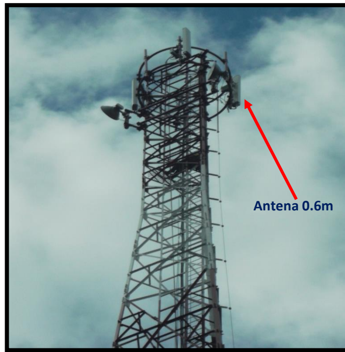
Figura 4.8-Torre y Antena Instalada. Fuente: Elaboración Propia
