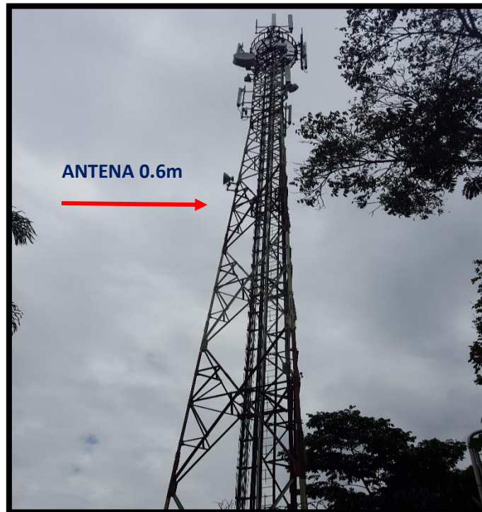
Figura 4.3-Torre y Antena Instalada Fuente: Elaboración Propia
