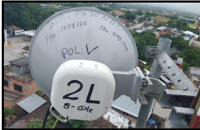
Figura 4.4- Antena y Odu Instalada en Torre. Fuente: Elaboración Propia
