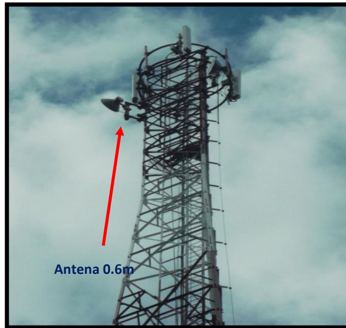
Figura 5.3- Torre y Antena Instalada. Fuente: Elaboración Propia
