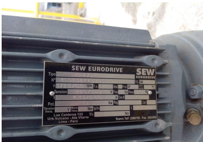
FIGURA 39 Moto reductor marca sew de 1.1.kw
