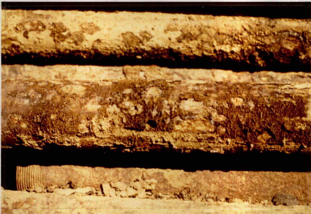
Figure 3.1. Photograph of DHE pipe.
