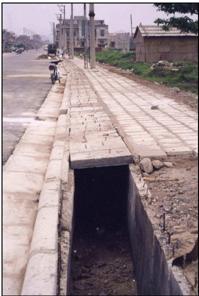
Figure 6: Égout destiné à canaliser et à évacuer les eaux de pluie dans le quartier de Dong Thanh. Photo : Éric Mottet, 2002.
