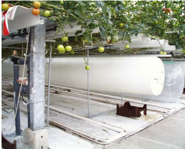
Figuur 10.1 Luchtslangen in de gesloten kas Foto: PPO.
