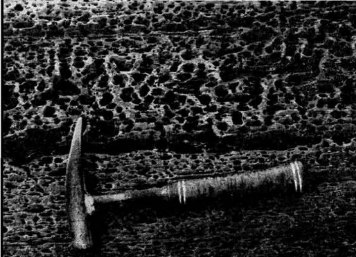
Photo 15 Schiste argileux alvéolé, à l'île Verte ; corrosion sur les embruns.
