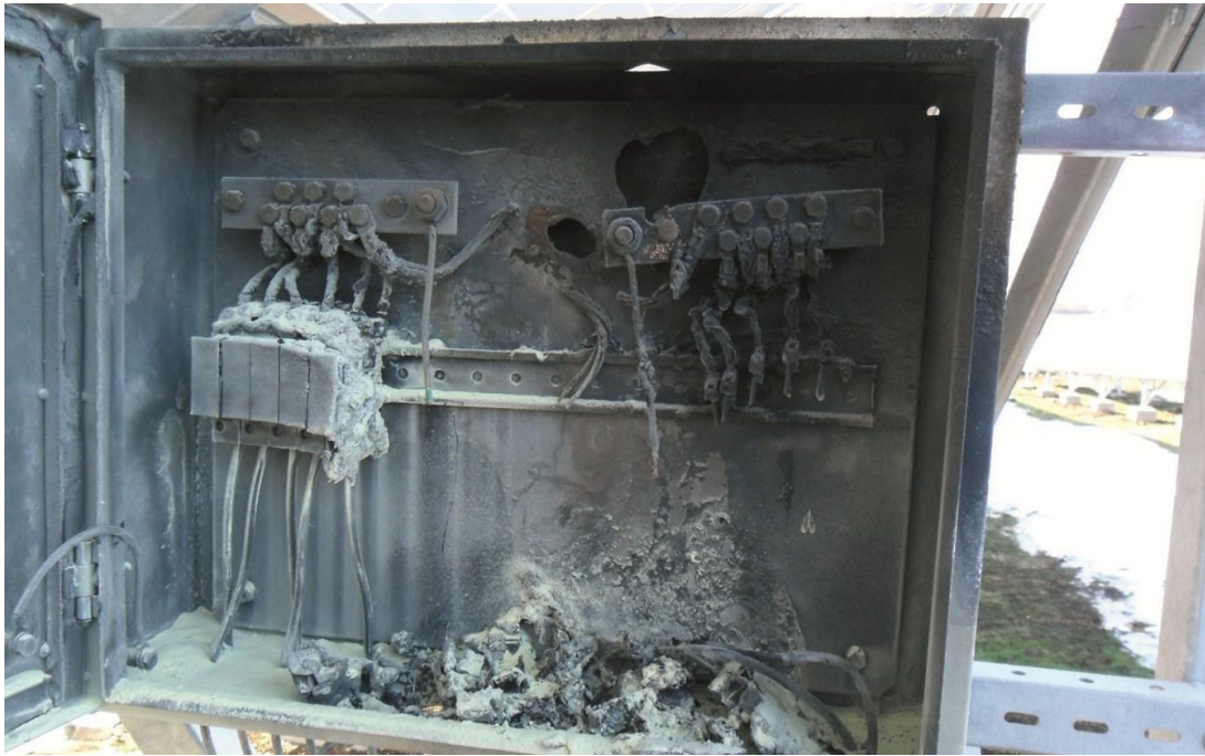
Rys. 5.10. Spalona rozdzielnica po stronie prądu stałego.
