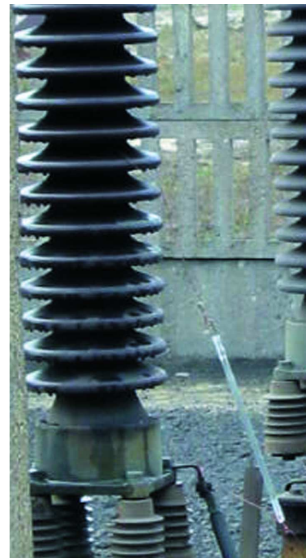
Bild 4. Massivstützer SWZP4 mit spezieller Sicherung
