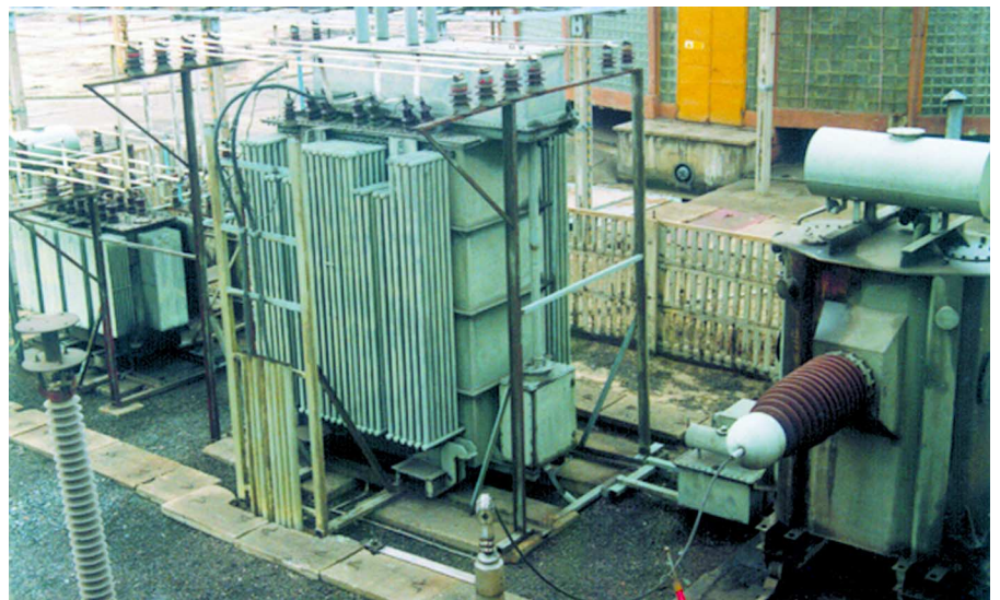
Bild 1. Die Leistungstransformatoren: Symmetrietransformator (l), Regeltransformator (Mitte), Hochspannungstransformator 6/200 kV (r)
