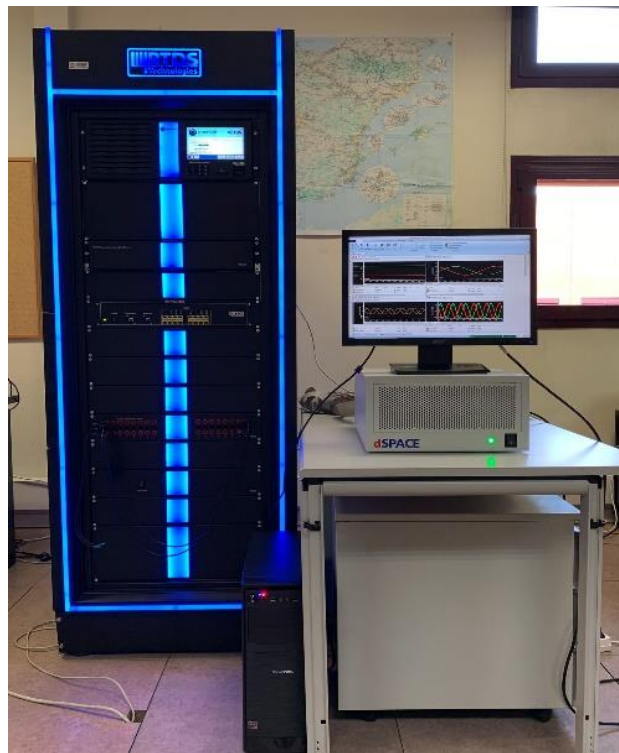
Fig.6.1. Montaje del banco de ensayos empleado para las simulaciones HIL, formado por el simulador en tiempo real (RTDS, izda) y la tarjeta controladora (dSpace, dcha).
