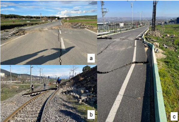
Şekil 3. Depremlerin (a,c) karayollarında ve (b) demiryollarında meydana getirmiş olduğu sol yanal deformasyon.
